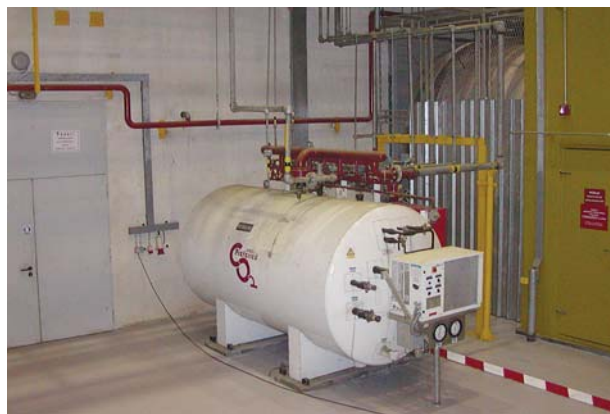
Slika 3. Sustav za gašenje sa CO 2 isporučuje se u sklopu postrojenja plinskih turbina (TE-TO Zagreb)
