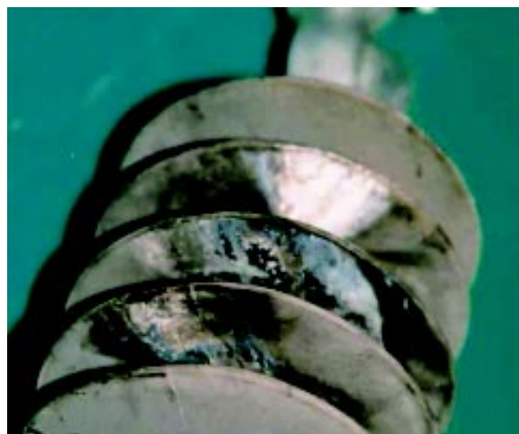
Slika 10. Stvaranje tragova, oštećenje lukom (sa 20 kV voda HEP Elektroistre)
