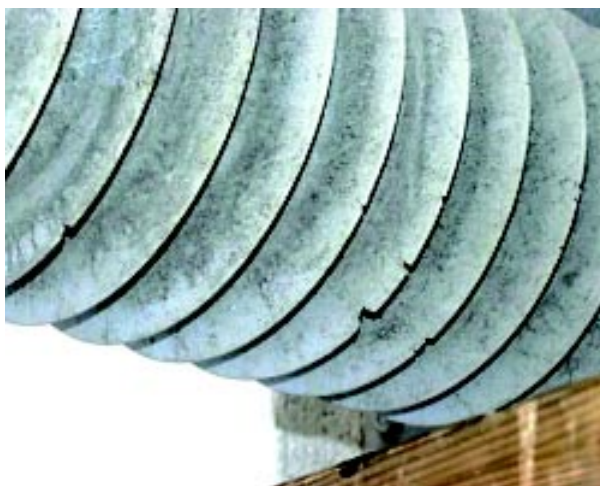
Slika 9. Pukotine i oštećenja rebara na provodnom izolatoru 110 kV u KK Toreta (Pag)
