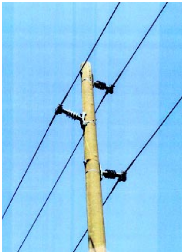
Slika 4. Kompozitni silikonski potporni izolatori na DV 20 kV TS 110/20 kV Rab – TS 20/0,4 kV Supetarska Draga
