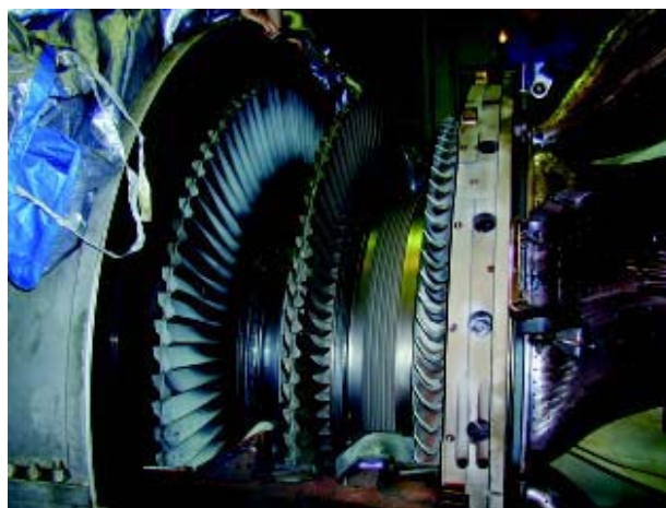
Slika 10. Rotor plinske turbine (1., 2., 3. stupanj turbinskih lopatica)
