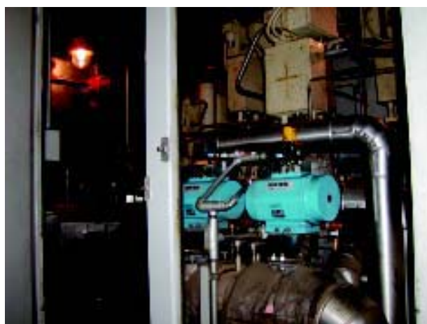
Slika 7. Pregled ventila propuhivanja sapnica komora izgaranja u plinskom odjeljku (u pozadini regulacijski i zaporni ventil)
