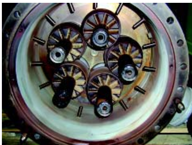
Slika 5. Pregled sustava izgaranja – komore su rastavljene, pregled sapnica
