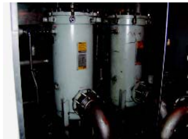
Slika 4. Pregled pri stajanju u pričuvi uključuje promjenu filtra, provjeru razine ulja, kalibraciju, provjeru elektronskih sustava, provjeru stanja akumulatorske baterije itd.
