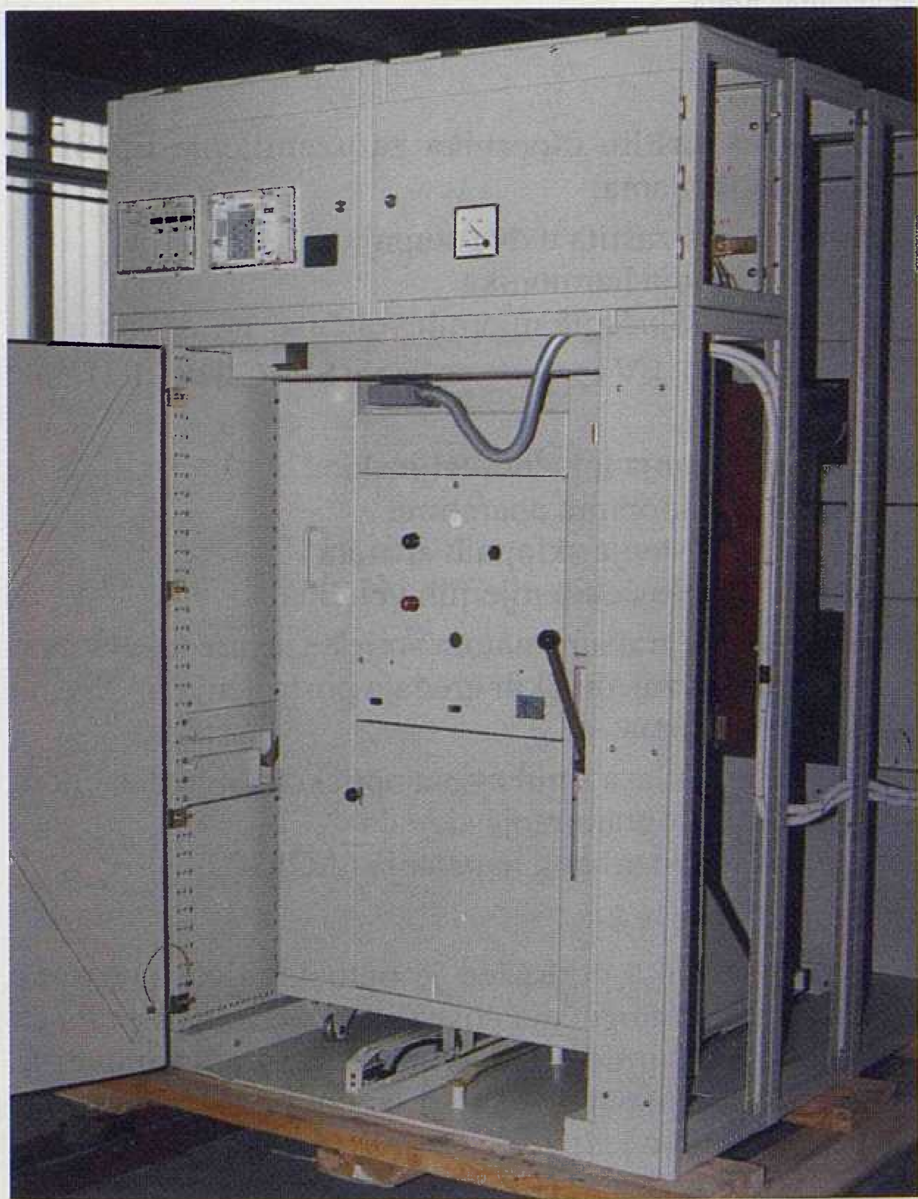
Slika 38. Sklopni blok BIP38
