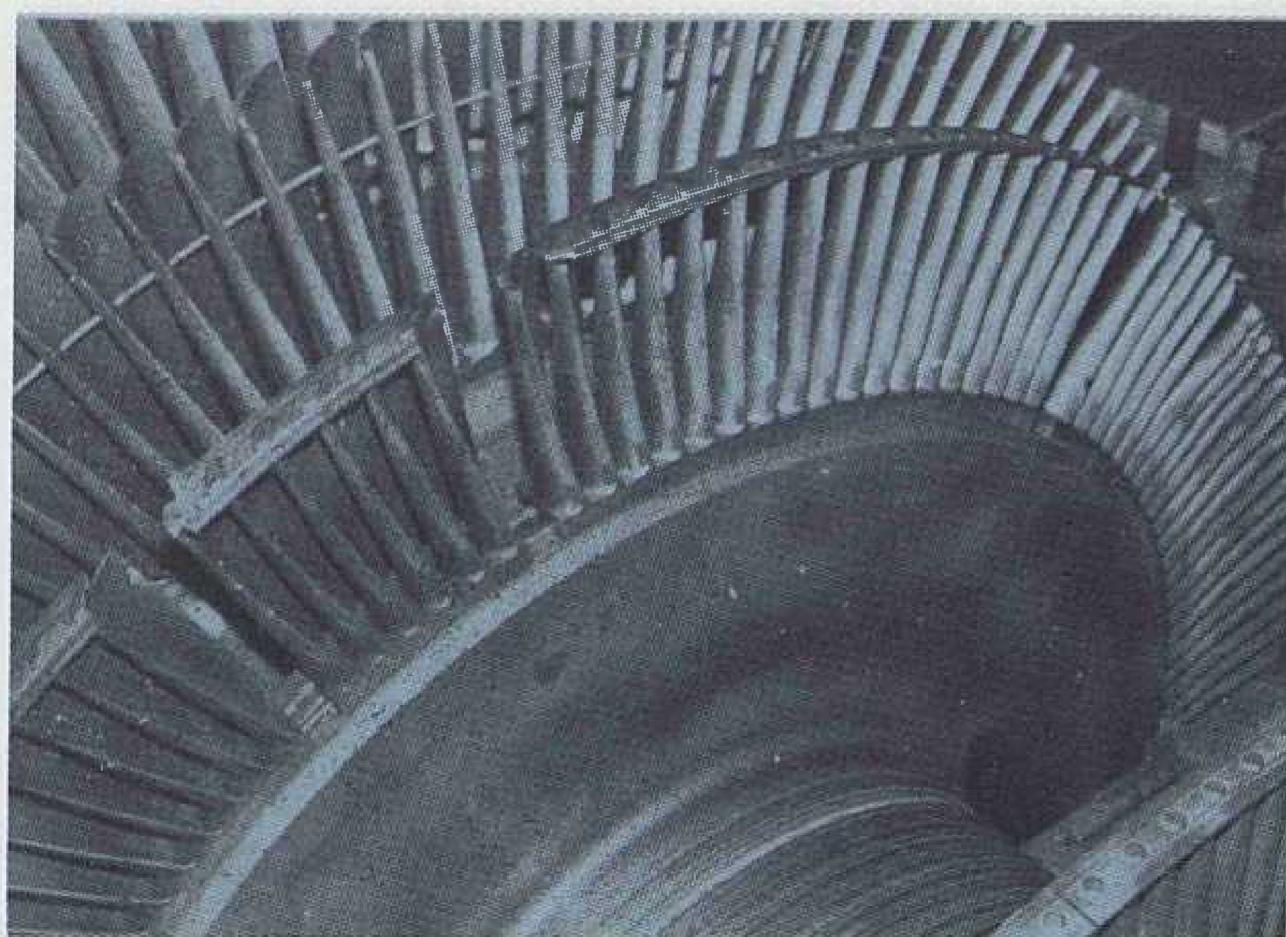
Slika 3. Oštećenja i lom rotorskih lopatica 18. stupnja kondenzacijske turbine s reguliranim oduzimanjem pare, snage 50 MW
