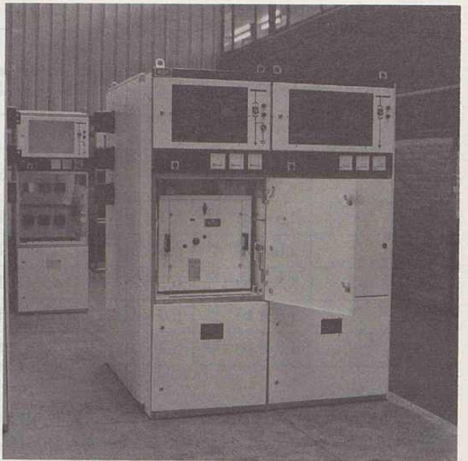
Kelija sa izvlačivim SF6 prekidačem, 12 kV
