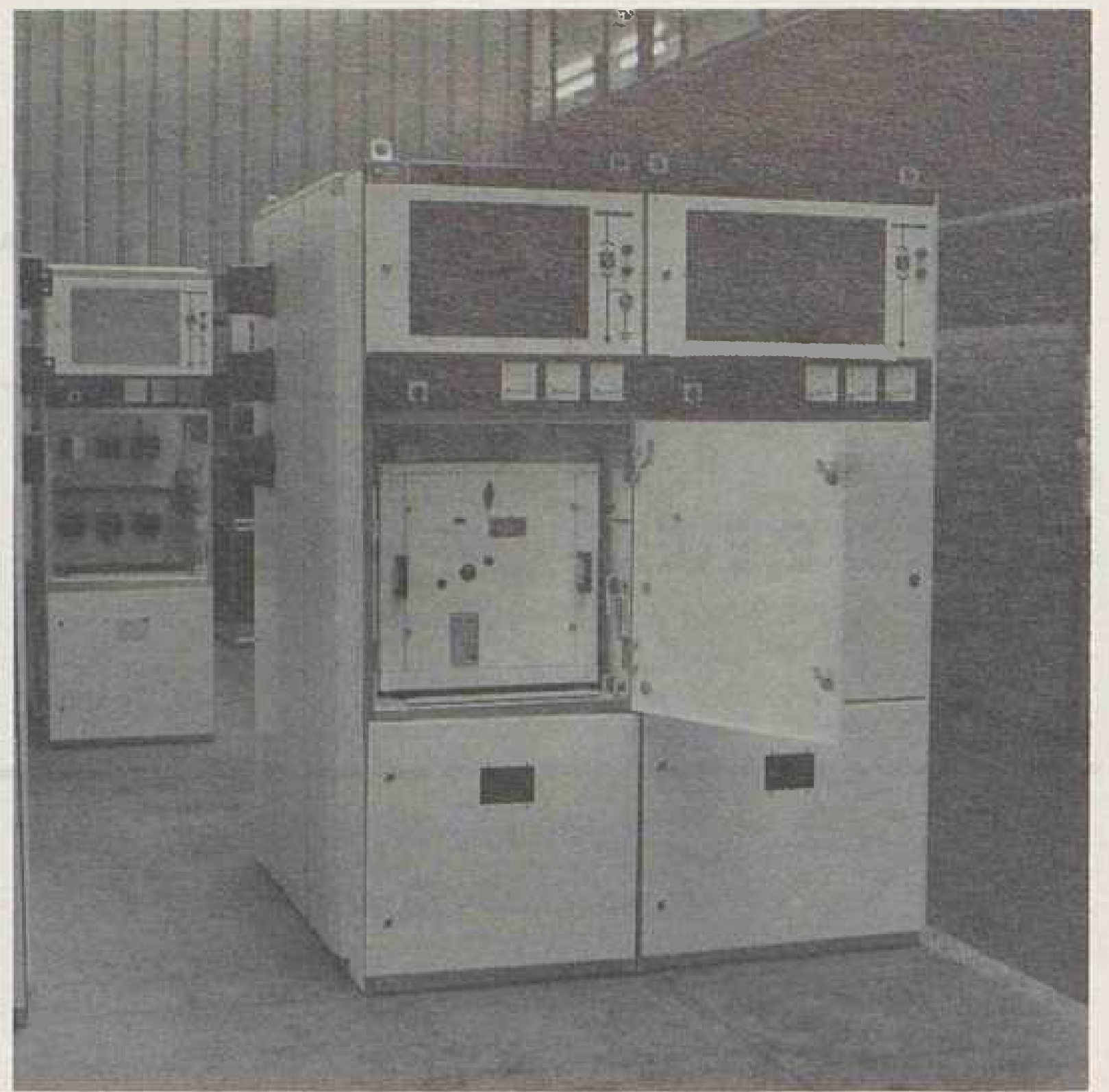
Kelija sa izvlačivim SF6 prekidačem, 12 kV
