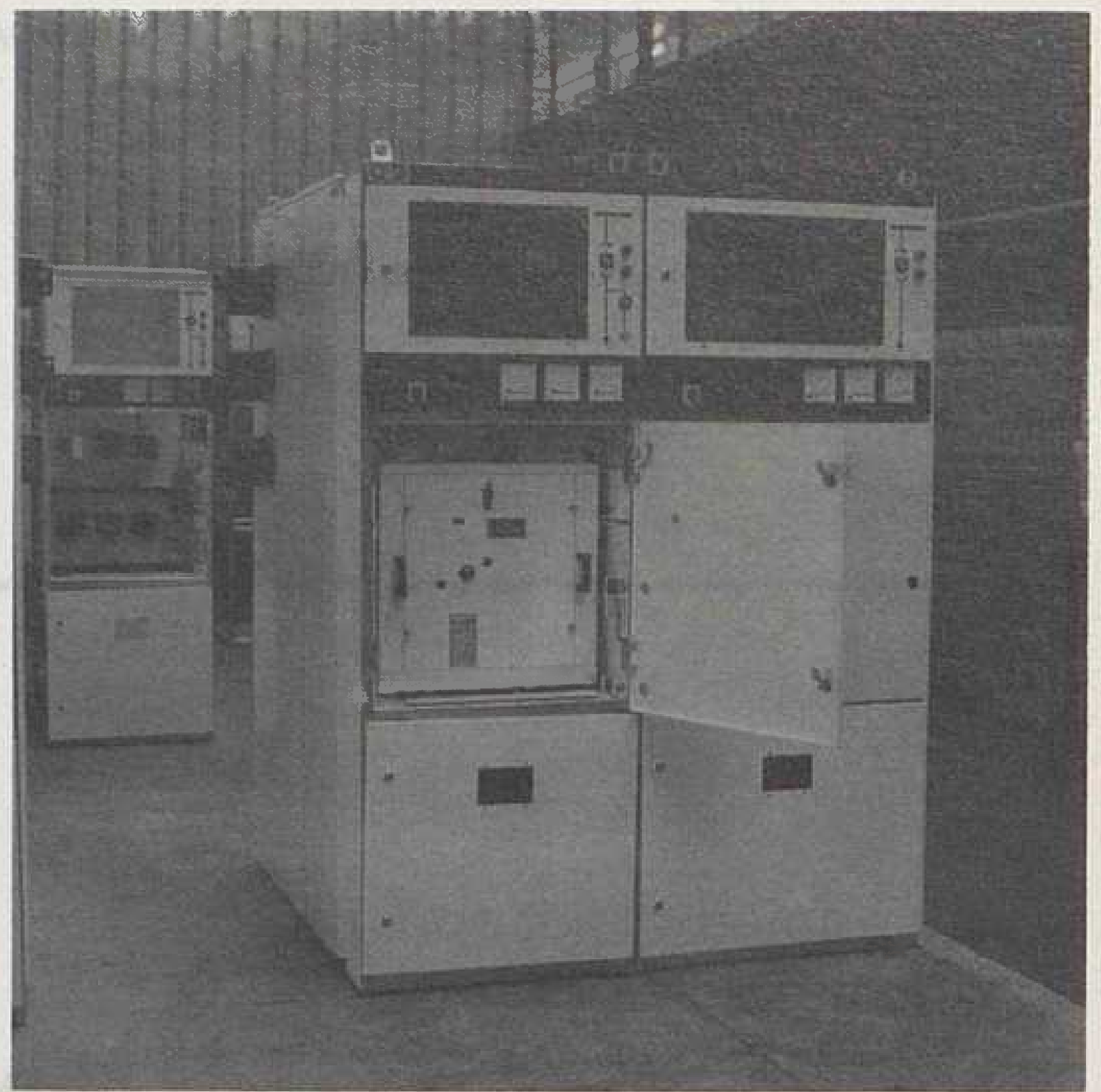
Kelija sa izvlačivim SF6 prekidačem, 12 kV
