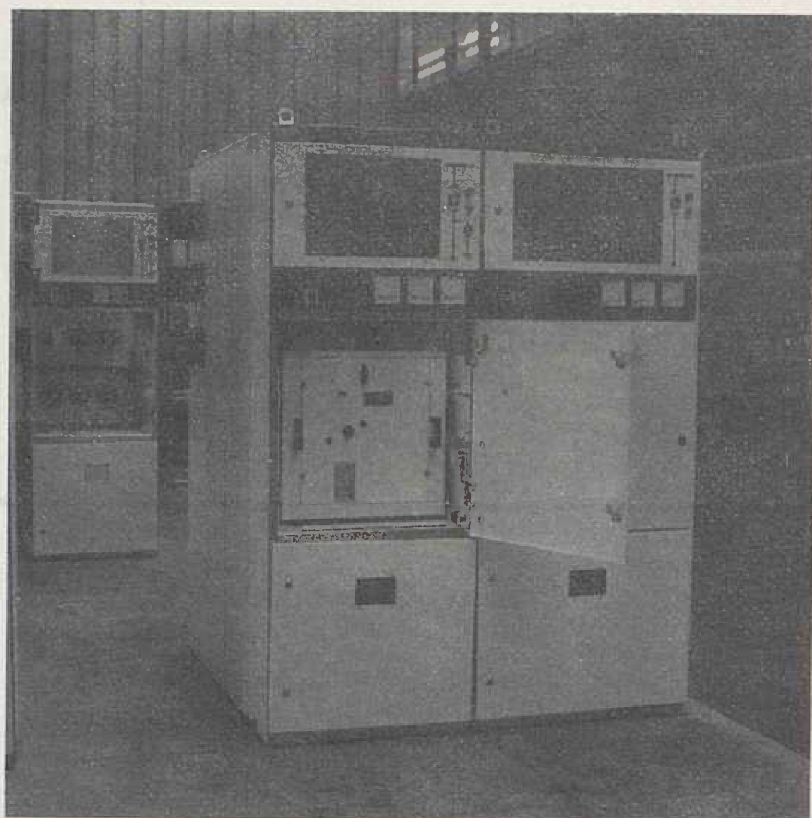
Kelija sa izvlačivim SF6 prekidačem, 12 kV
