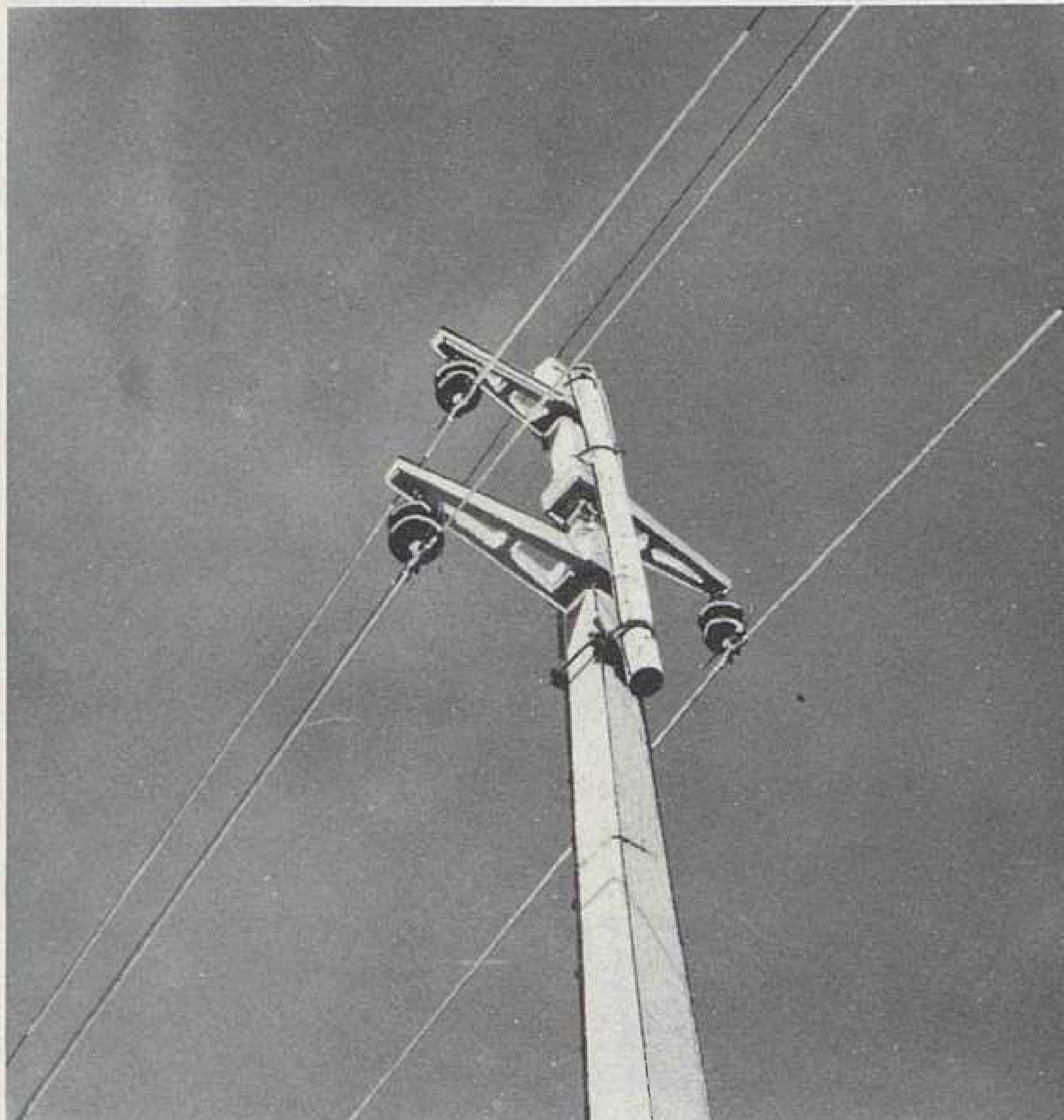
Slika 9. 35 kV-tni dalekovod HE Vinodol-Plase
