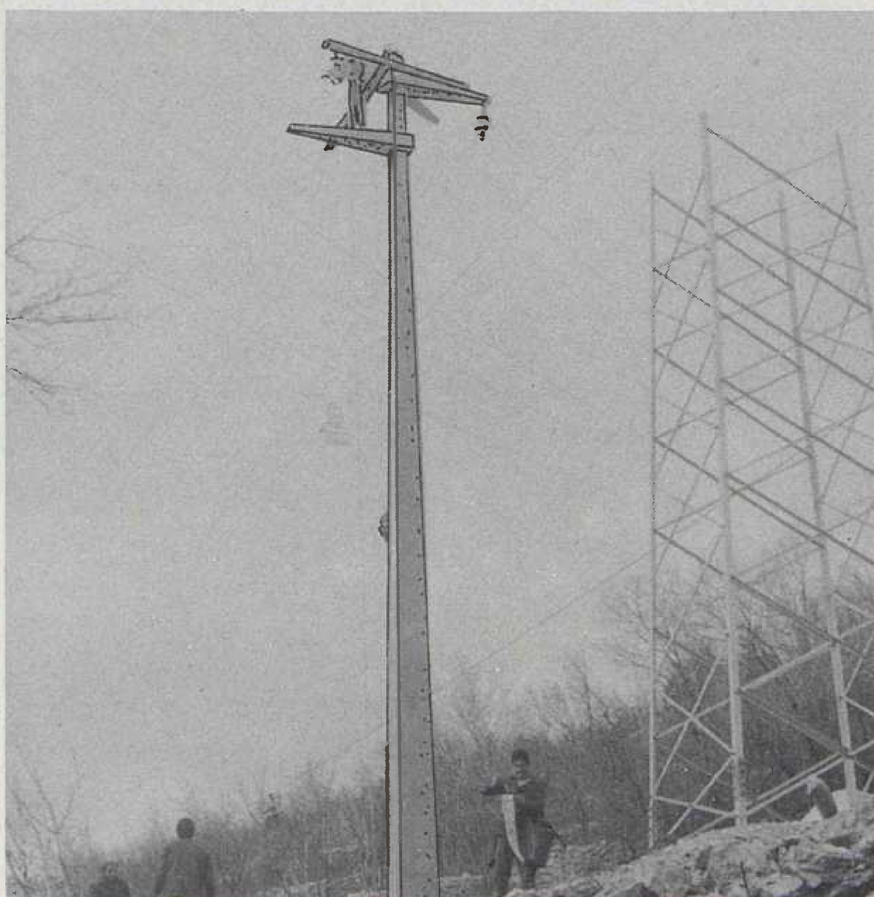
Slika 10. 35 kV-tni dalekovod Krasica-Plase
