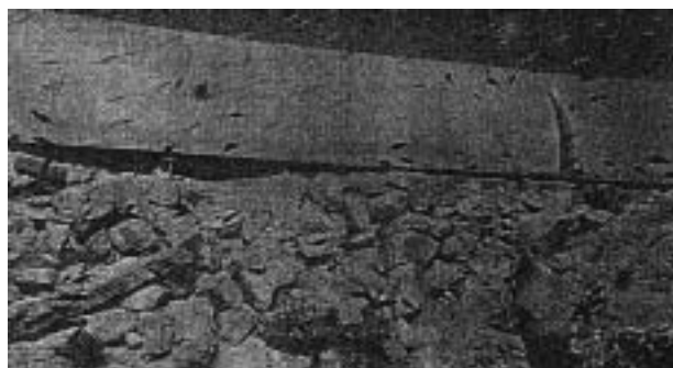
Slika 5. Oštećenje na novoj priobalnoj zaštiti (o. Obonjan)
