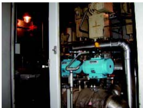
Slika 7. Pregled ventila propuhivanja sapnica komora izgaranja u plinskom odjeljku (u pozadini regulacijski i zaporni ventil)
