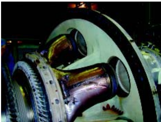
Slika 8. U sredini prijelazni kanali vrućeg plina koji spajaju komore izgaranja (na desnoj strani) prema sapništu i lopatičju prvog turbinskog kola (na lijevoj strani)
