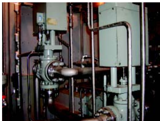
Slika 3. Zaporni i regulacijski ventil tekućeg goriva s razdjelnikom (u sredini slike) prema komorama izgaranja
