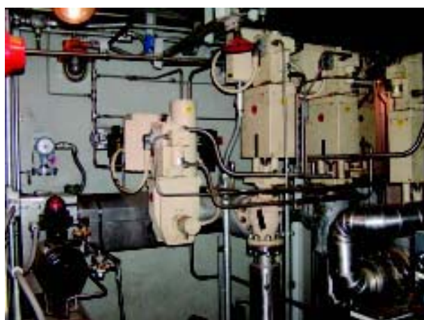
Slika 6. Pregled plinskog zapornog i regulacijskih ventila
