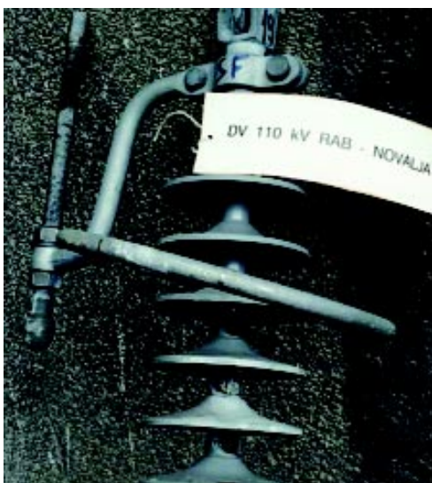
Slika 7. Lagana erozija plašta jezgre 110 kV izolatora (neadekvatno rješenje zaštitnog prstena)
