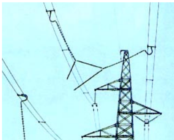
Slika 20. Lom međufazne izolatorske konstrukcije (djelovanje leda i vjetra, loša izvedba)
