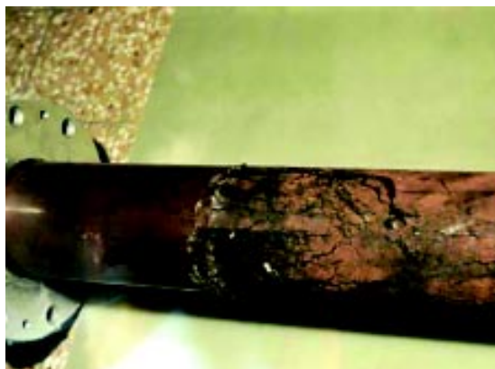
Slika 15. Jaka erozija i uništenje površine provodnog izolatora 110 kV (neadekvatan izbor)
