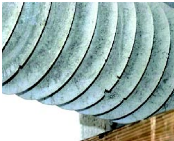
Slika 9. Pukotine i oštećenja rebara na provodnom izolatoru 110 kV u KK Toreta (Pag)
