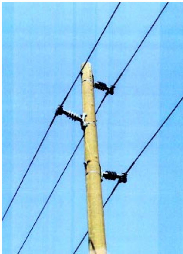
Slika 4. Kompozitni silikonski potporni izolatori na DV 20 kV TS 110/20 kV Rab – TS 20/0,4 kV Supetarska Draga
