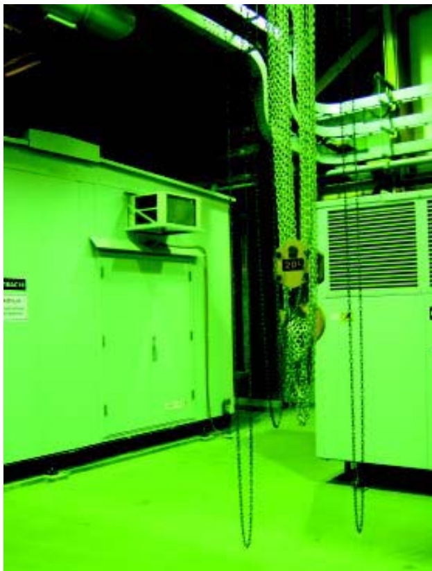
Slika 10. Ulaz u upravljački modul u kojem je smješten generatorski prekidač
