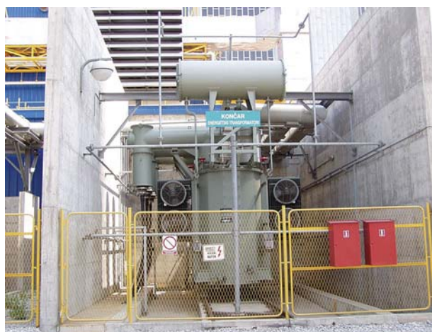
Slika 6. Gašenje transformatora - dvije razine cijevi za vodu i požarni zidovi F90
