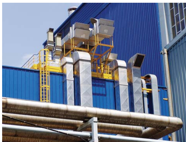
Slika 7. Ventilacija na strojarnici – odsisavanje prema krovu strojarnice
